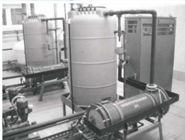
Установка хлорирования воды
